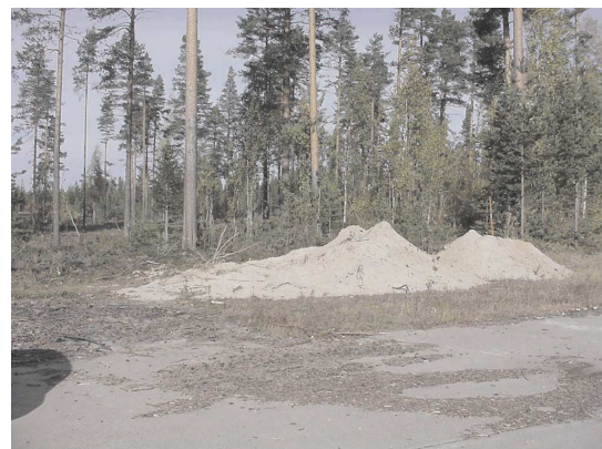
Figur 13. Miljö kring provgrop 10. Kabel- typ EPJ, fyra st parallella kablar på ca 20 cm djup.
