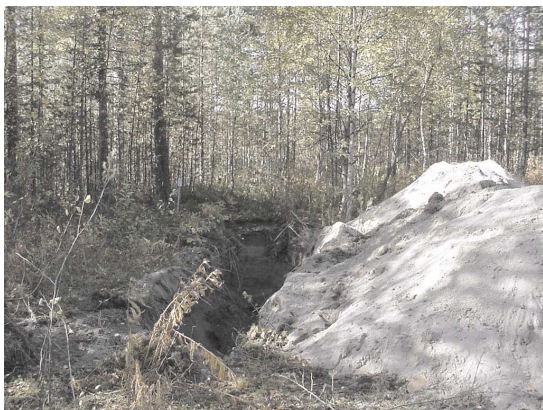
Figur 4. Provgrop 1. Kabeltyp EKKJ och EPJ, båda kablarna hade dragits parallellt i samma grop, på samma djup med ca 2 m avstånd.
