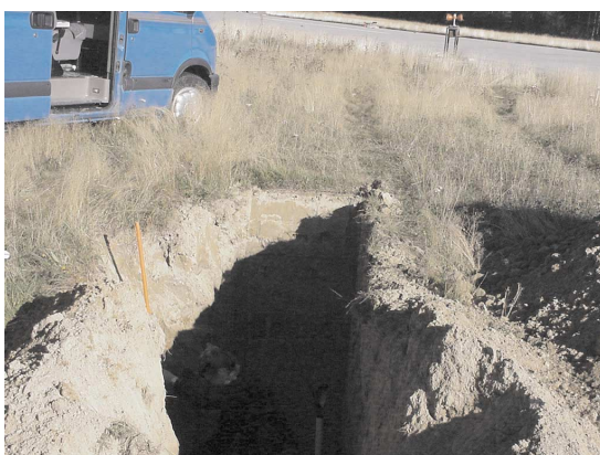
Figur 8. Miljö kring provgrop 5. Kabeltyp EKKJ.
