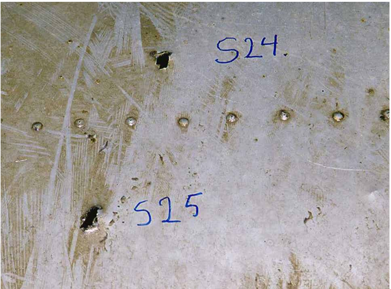
Figur 30 Detalj, utgående splitterskada S24-S25
