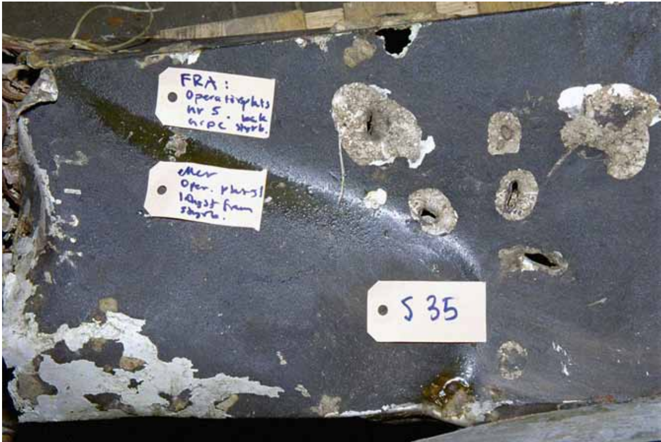
Figur 75 Detalj, brisadnära splitterskador i elektronikbox S35
