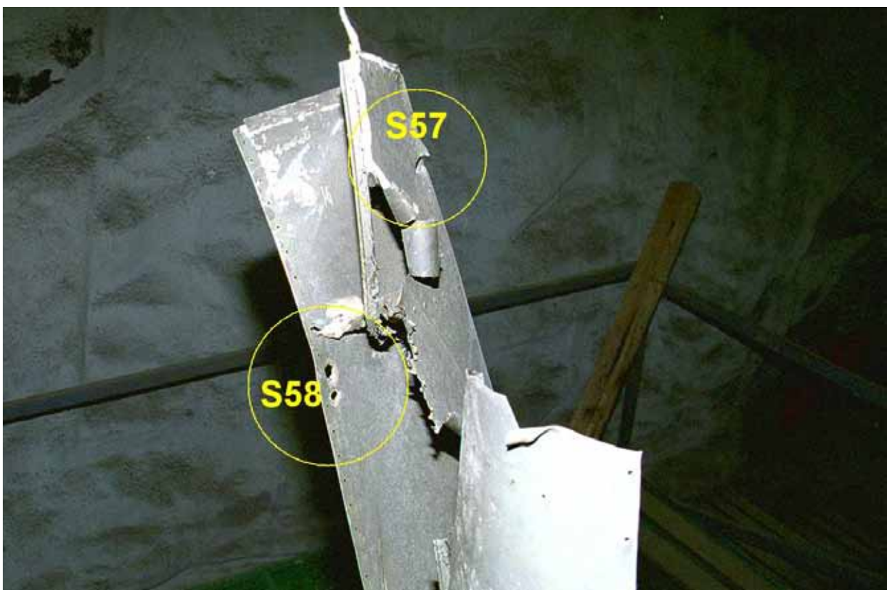
Figur 71 Detalj, utgående splitterskada S57-S58 på vänster resp. höger sida av fenbasens förlängning förut
