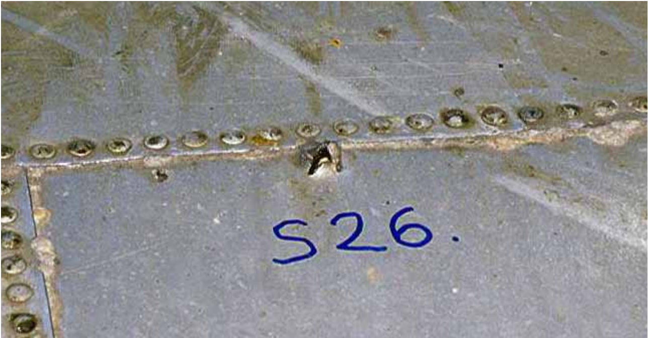
Figur 31 Detalj, utgående splitterskada S26
