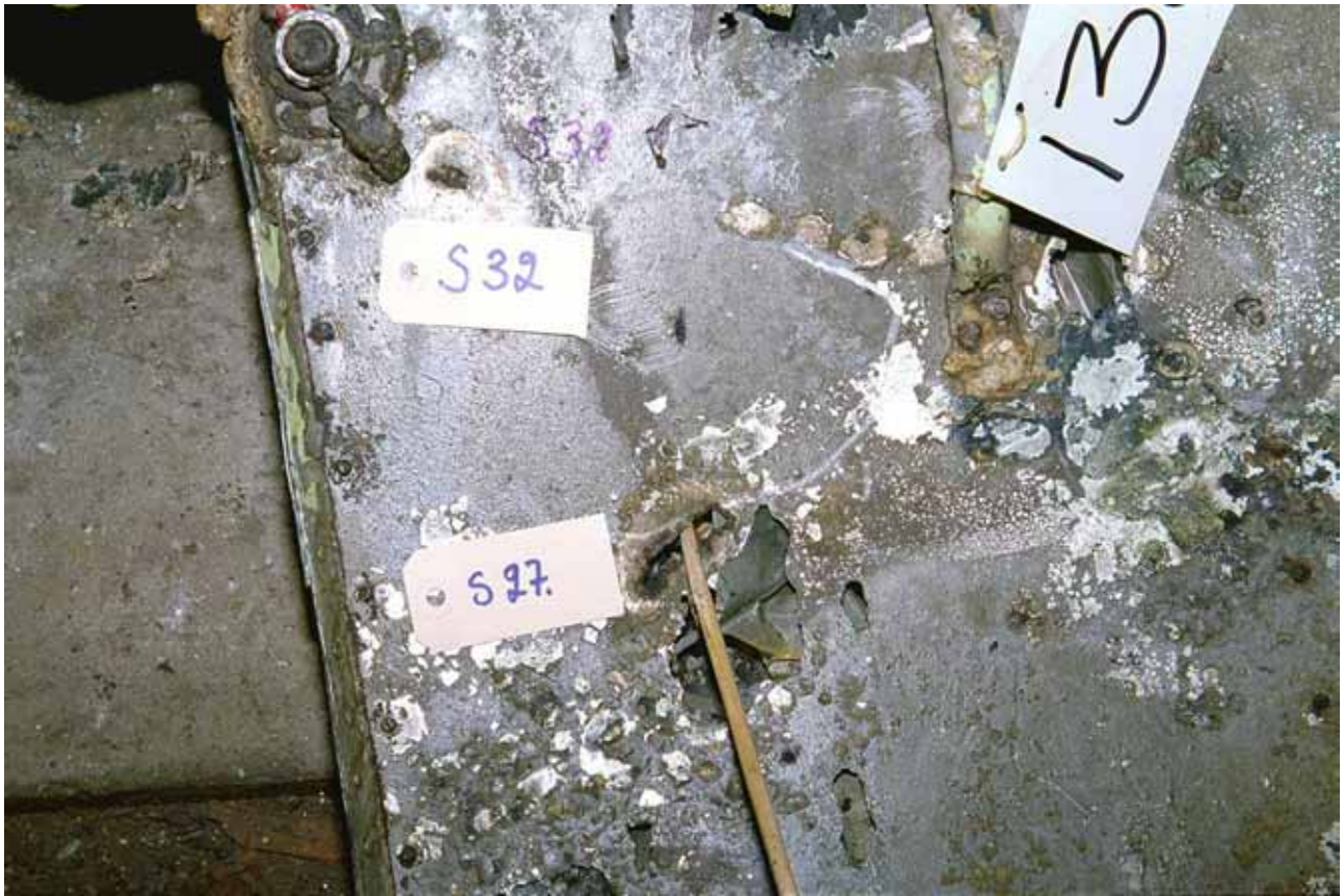
Figur 35 Detalj, splitterskada S27, S32 (fallskärmsdörrens insida)
