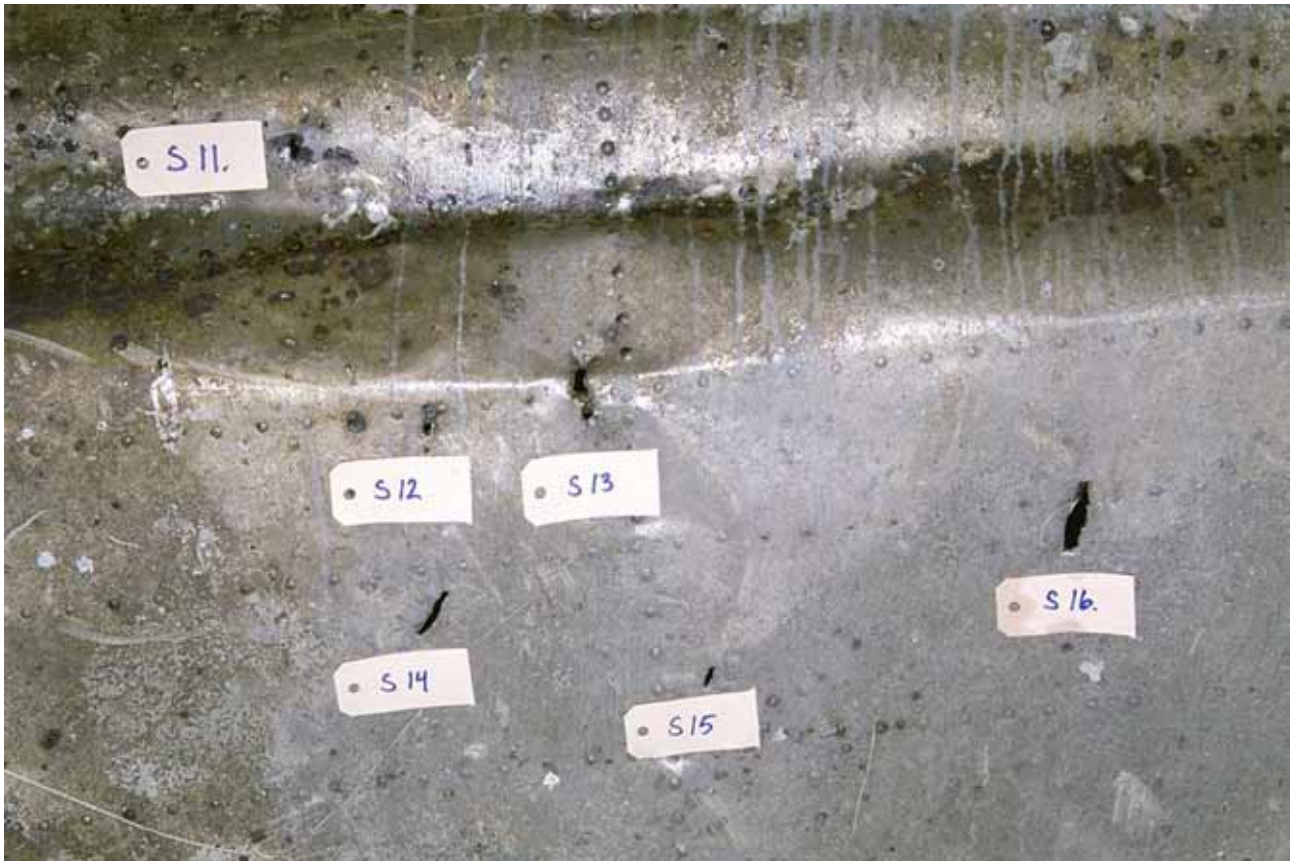
Figur 23 Detalj, splitterskada S11-S16
