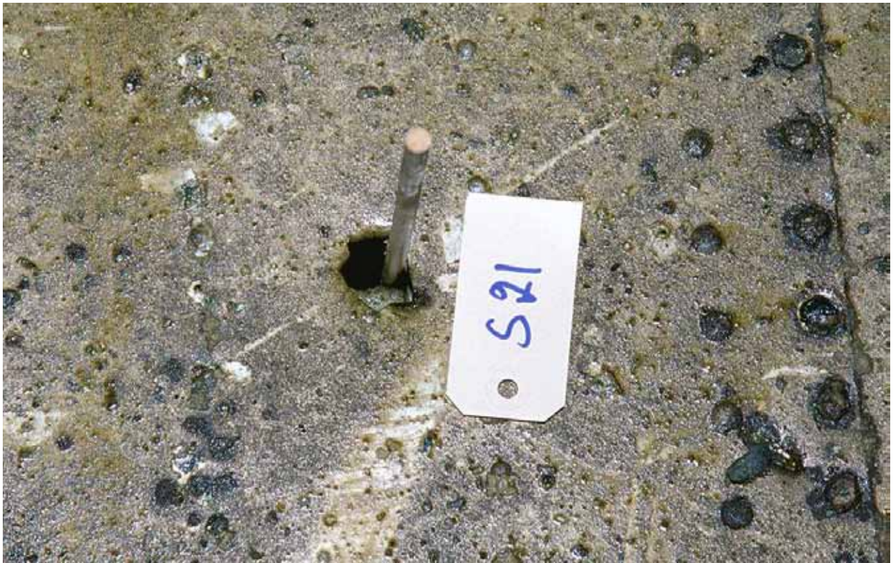
Figur 25 Detalj, splitterskada S21
