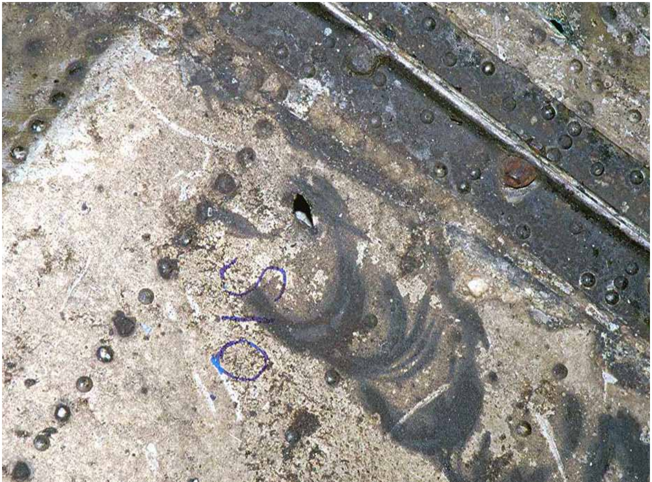
Figur 21 Detalj, splitterskada S10
