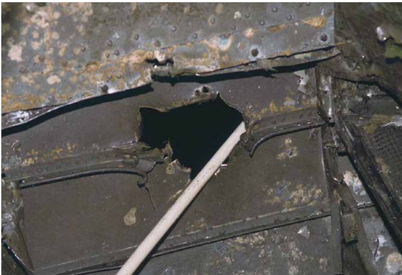
Figur 12 Detalj, brisadskada S04 inifrån
