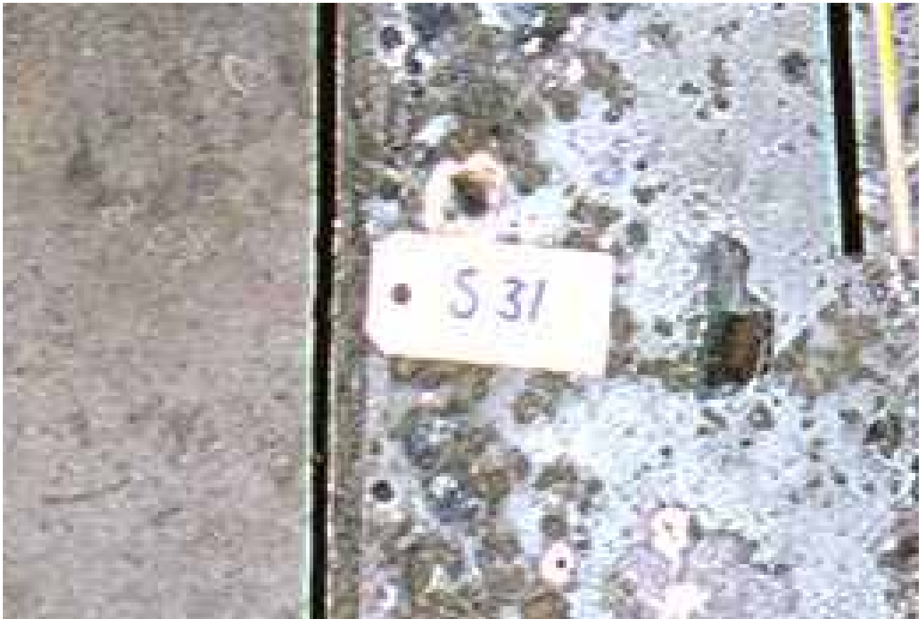
Figur 37 Detalj, splitterskada S31 (fallskärmsdörrens insida)
