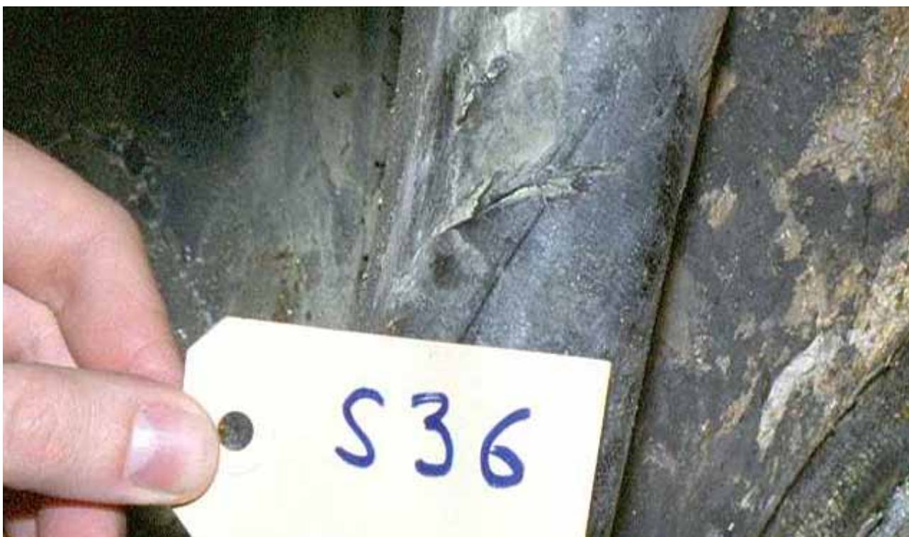
Figur 43 Detalj, splitterskada S36A
