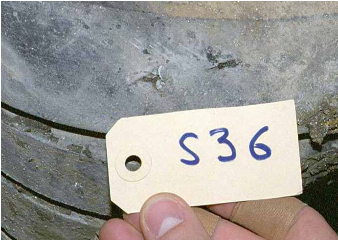
Figur 44 Detalj, splitterskada S36B
