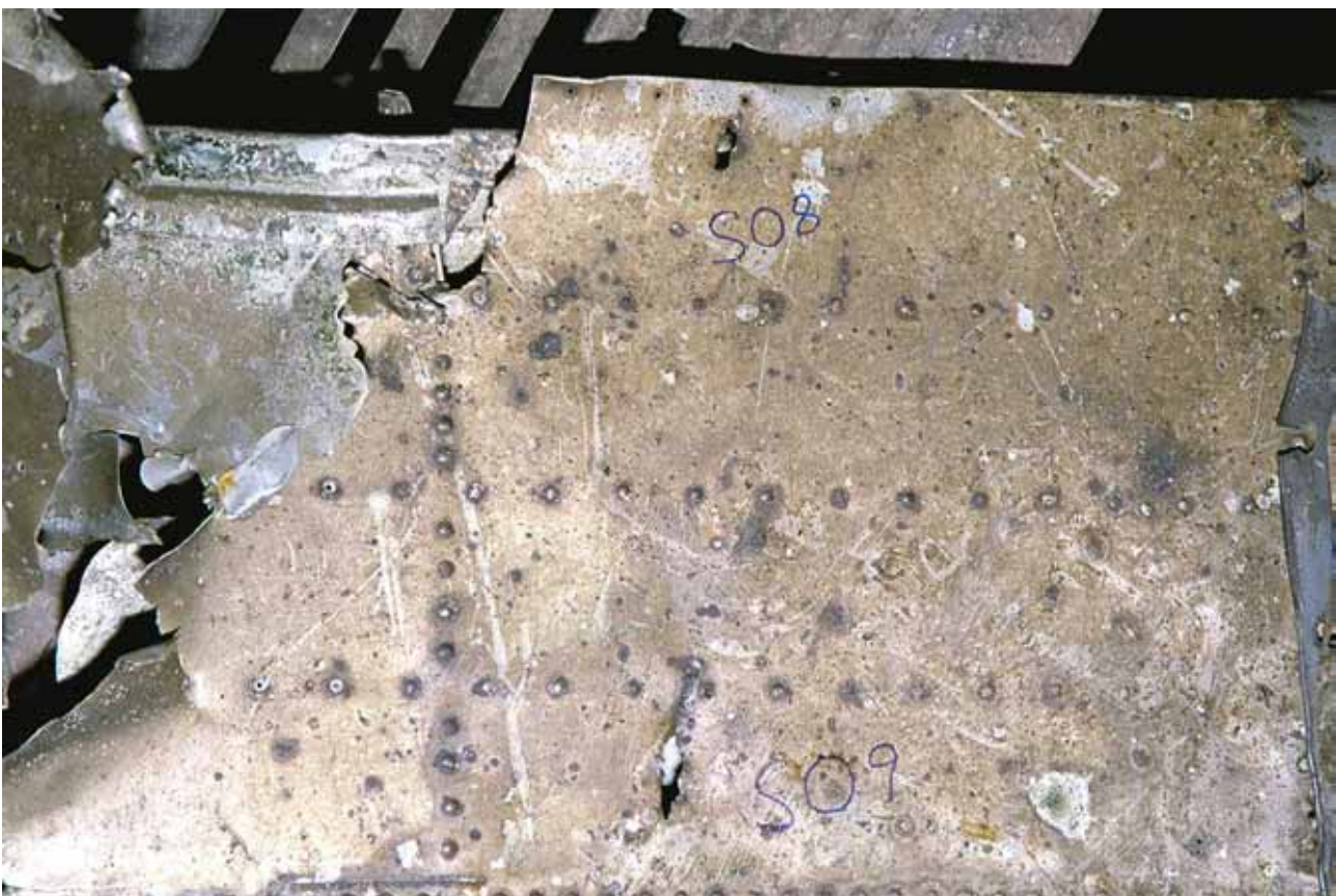
Figur 20 Detalj, splitterskada S08-S09
