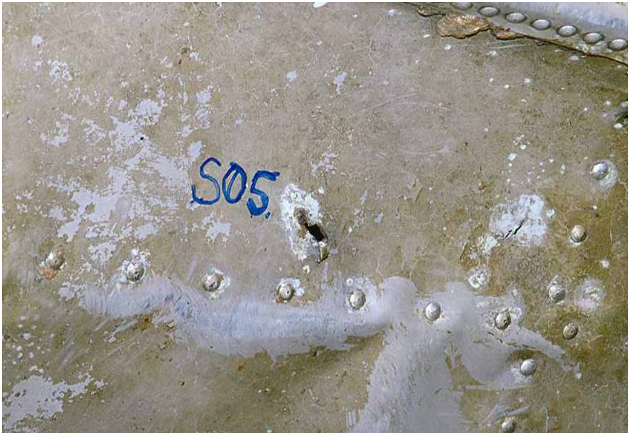
Figur 14 Detalj, utgående splitterskada S05
