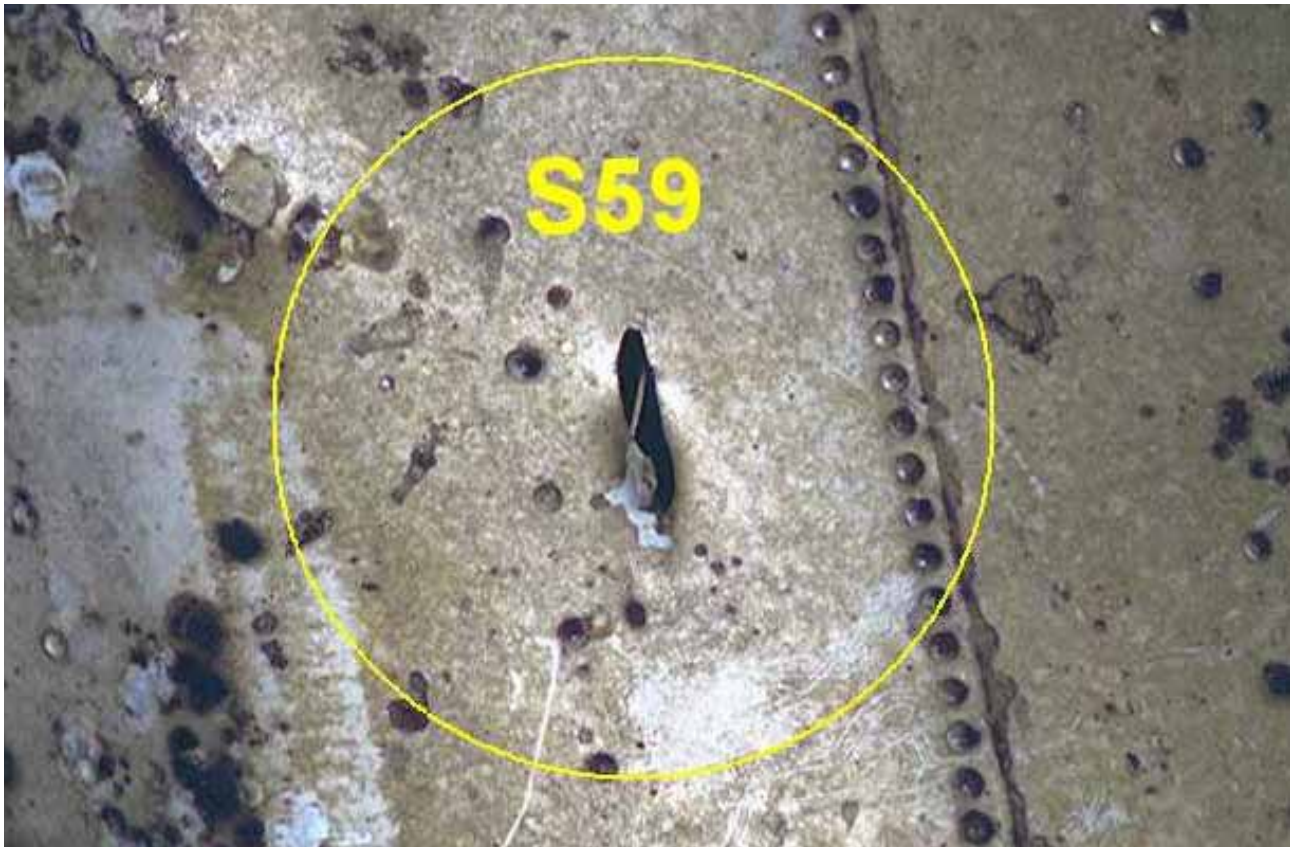
Figur 74 Detalj, splitterskada S59
