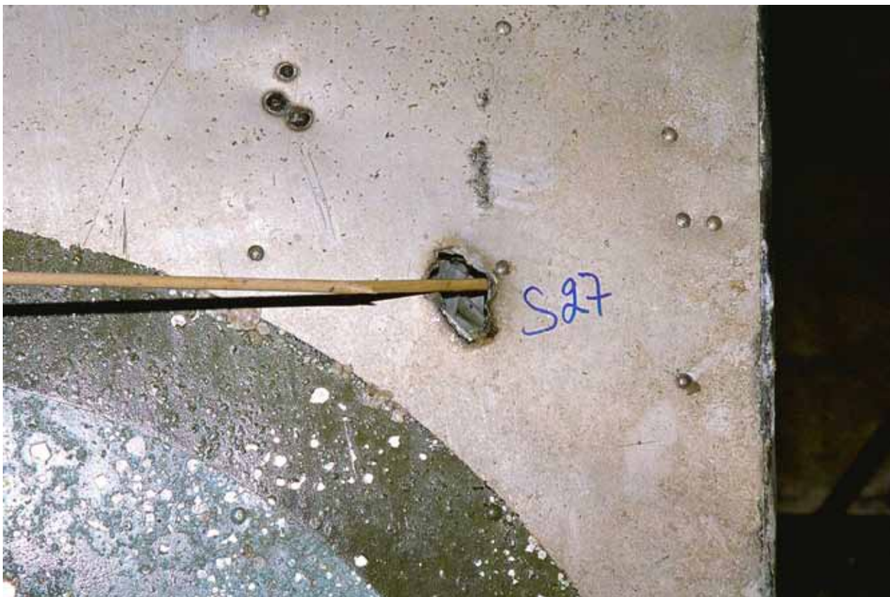
Figur 33 Detalj, splitterskada S27 (utträde)
