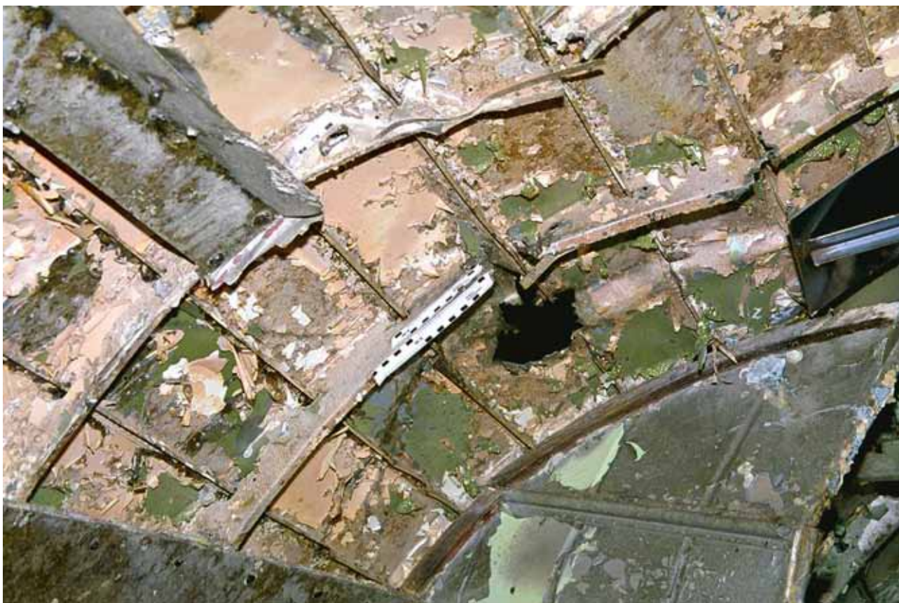
Figur 7 Brisadskada S01 inifrån, främre toalettvägg synlig i bildens högre, nedre del
