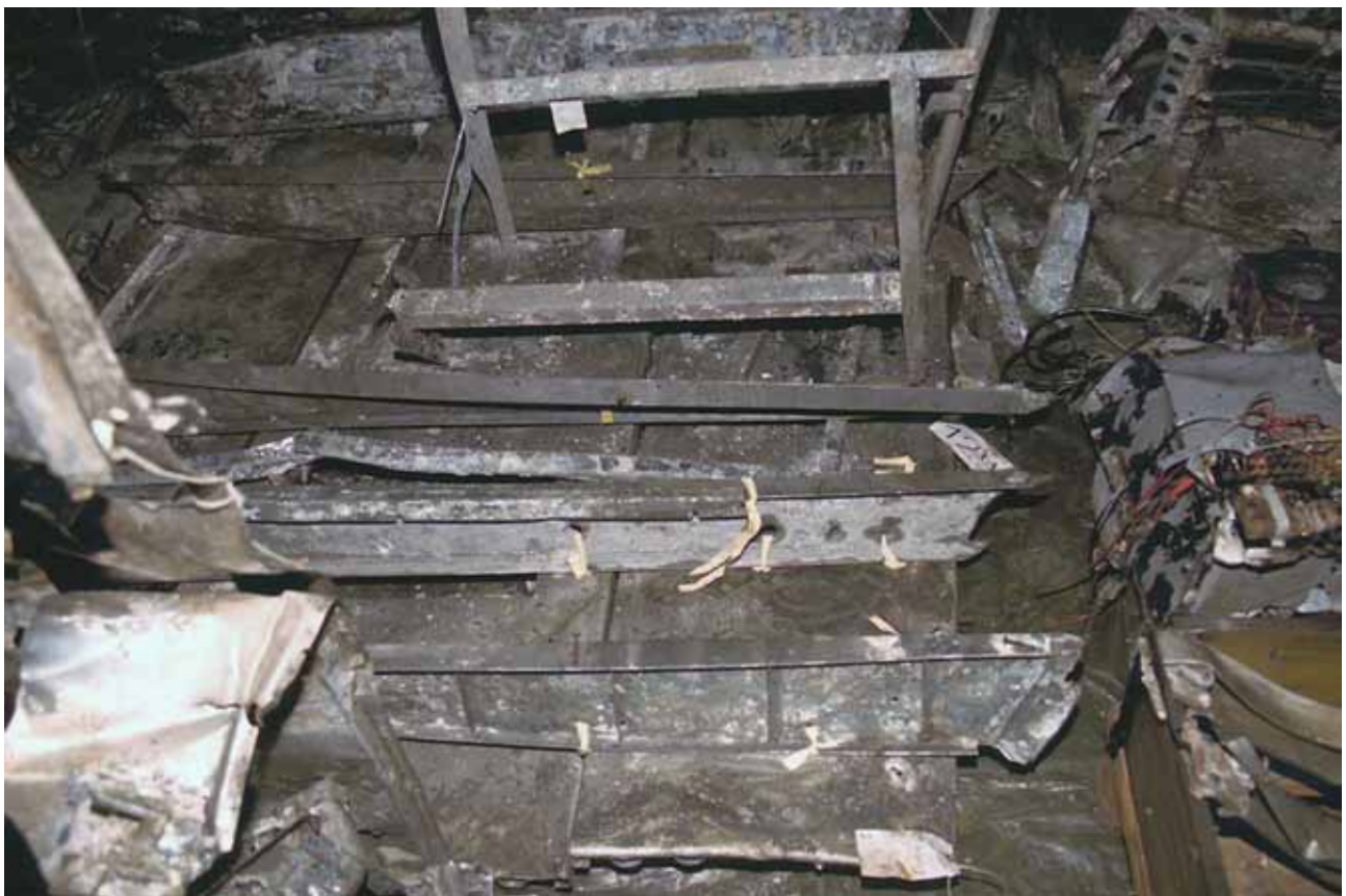
Figur 17 Splitterskador i golvbalkar (markerade med gula snitslar), sannolikt härrörande från brisad i S04
