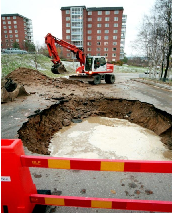
Vattenläcka i Sundsvall, hösten 2003. Foto: Sundsvalls tidning
