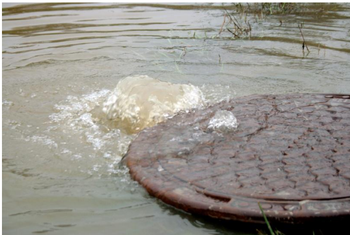
Översvämmad dagvattenbrunn i samband med kraftig nederbörd i Sundsvall, sommaren 2006. Foto: Sundsvalls Tidning
