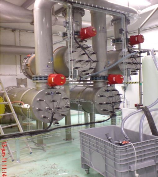
UV-anläggning vid Minnesgårdets vattenverk, Östersund. Foto: Conny Simonsson
